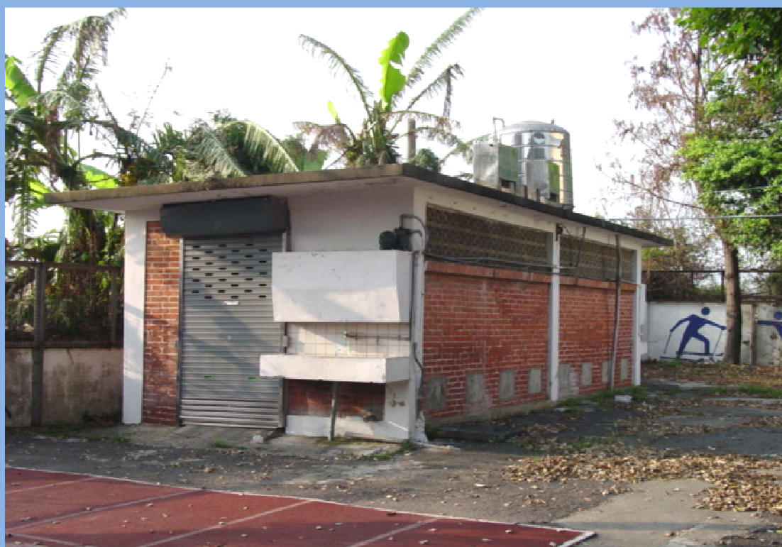
圖5-24》位於學校邊緣的老舊廁所易成為危險角落。
