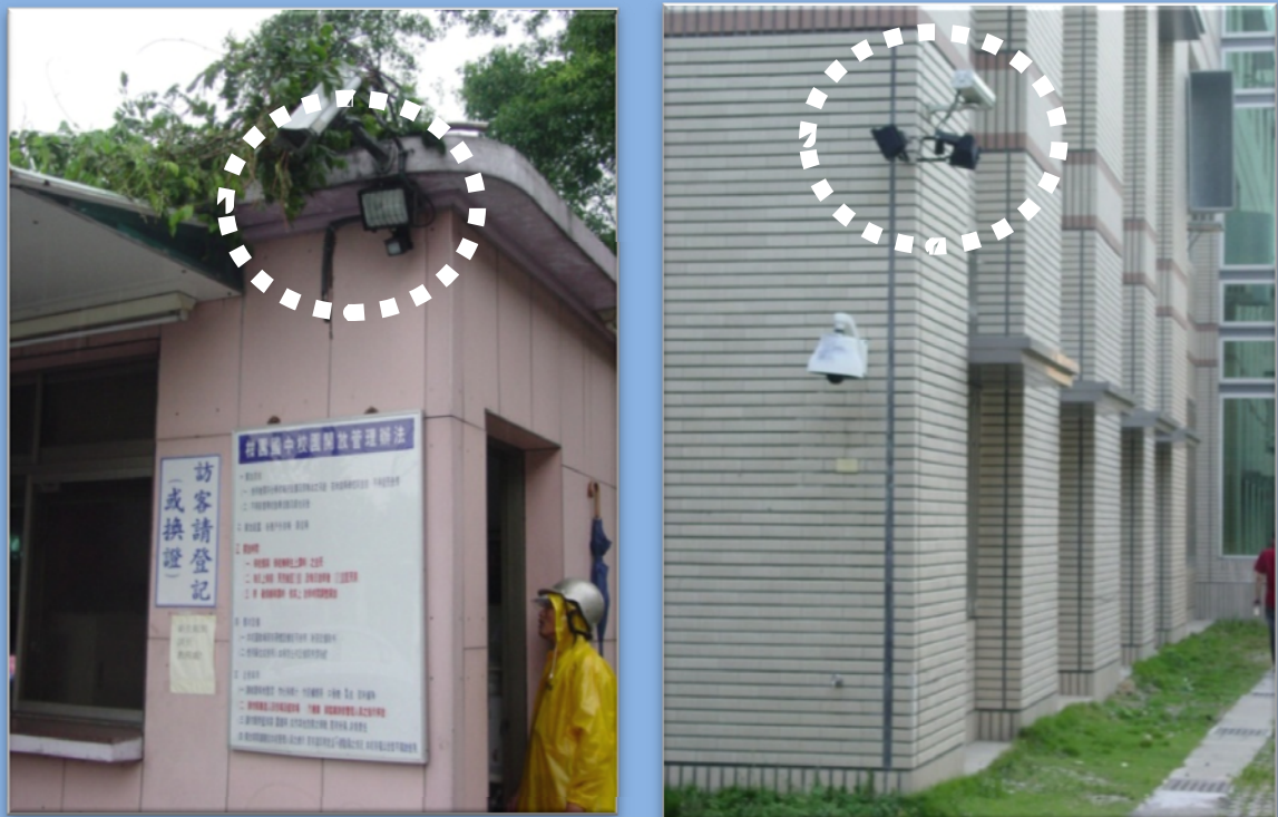
圖5-29.30 》不得已才裝設監視器的安全措施。
